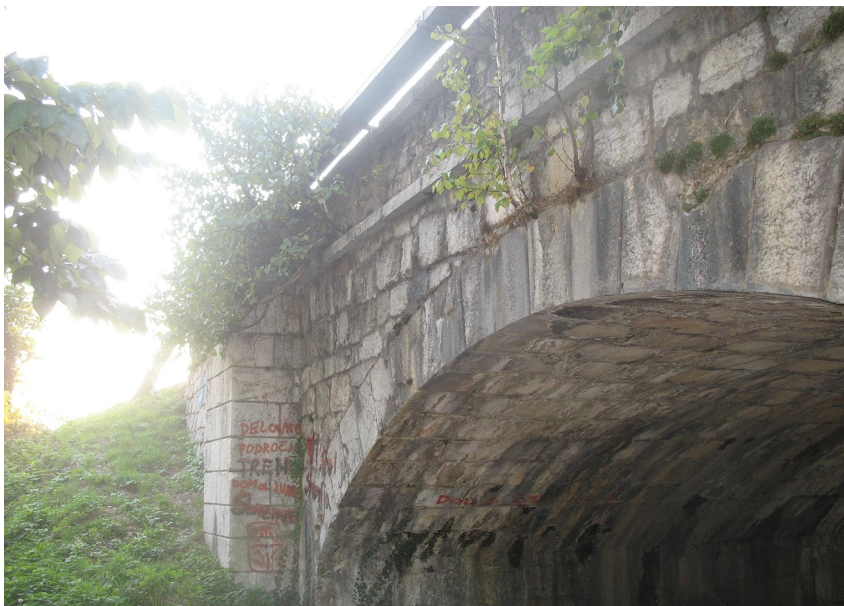
Slika 12 – Obraščenost parapetnih zidov oboka
