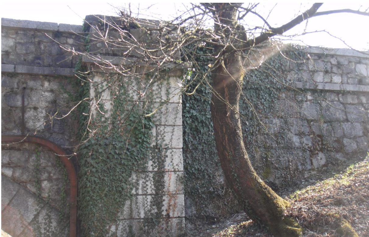
Slika 19 – Zaraščenost parapeta in krila na severni strani
