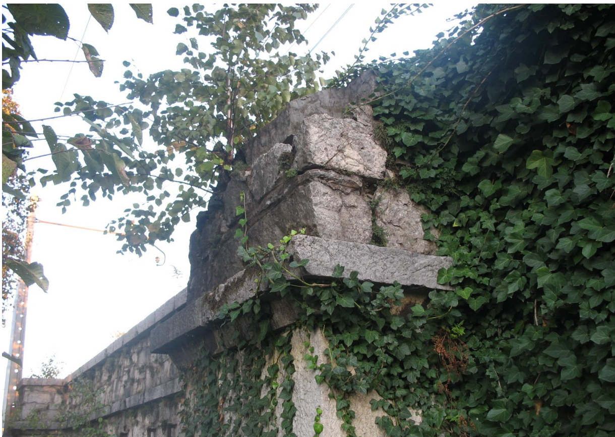
Slika 21 – Poškodovan ograjni parapet
