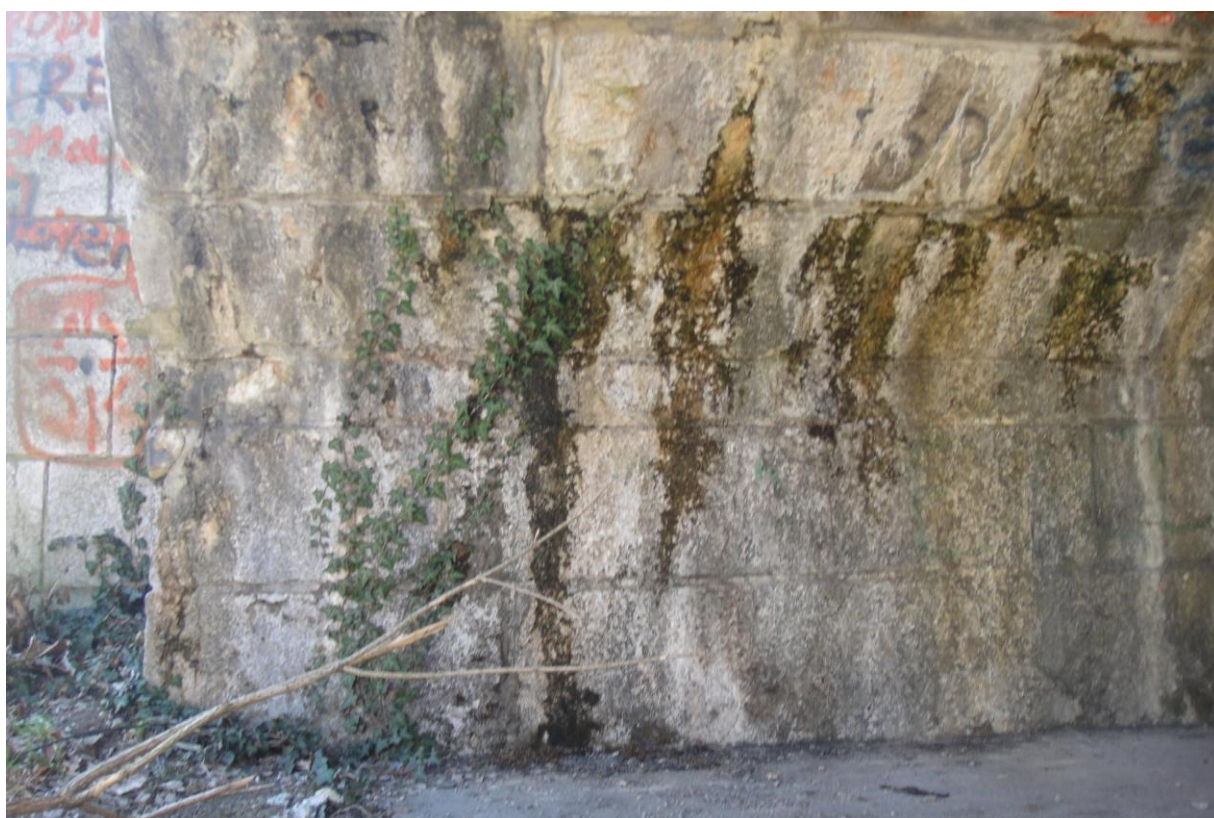
Slika 5 – Zamočenost oboka in opornikov, pronicanje vode med stiki kamnitih blokov
