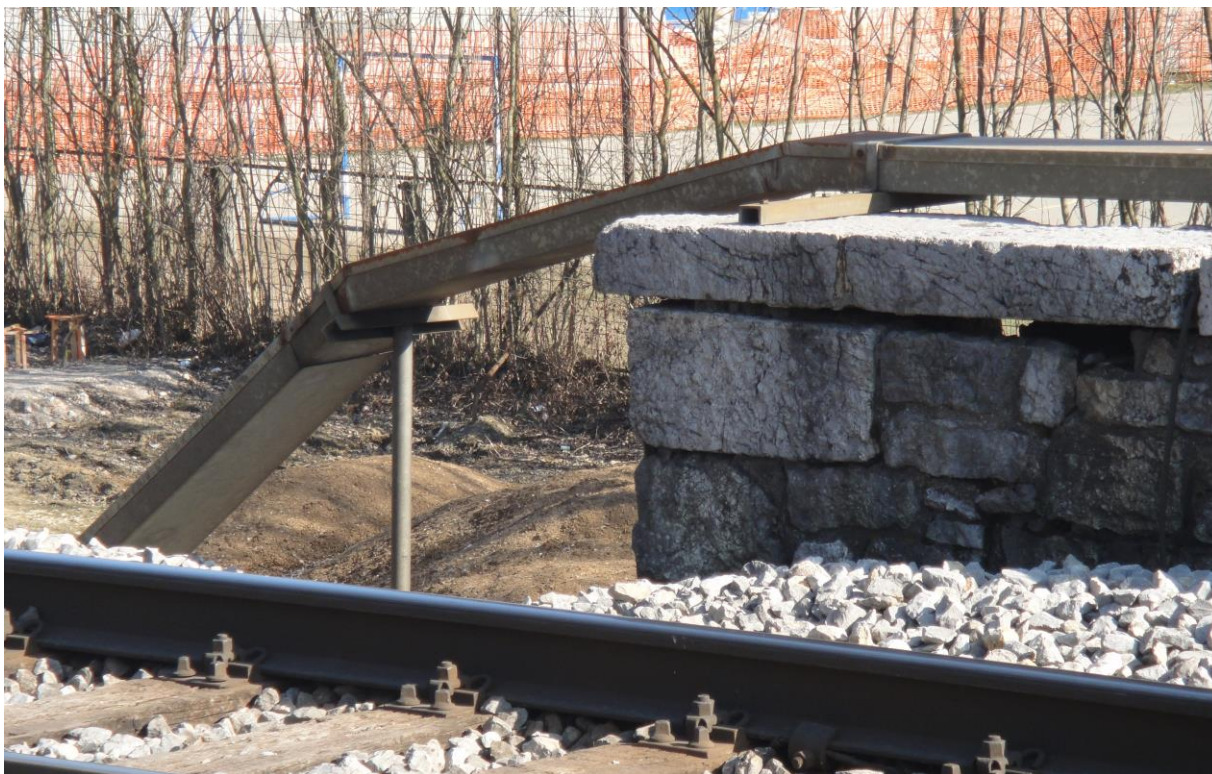
Slika 20 – Poškodovana kapa ograjnega parapeta
