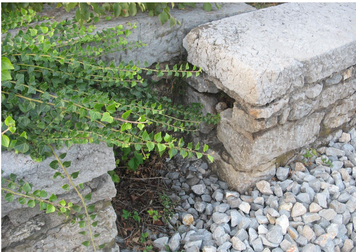
Slika 21 – Poškodovan ograjni parapet
